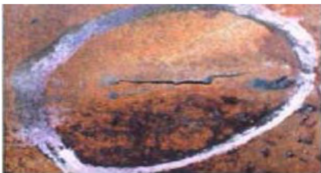
Hình 1.2. Đường ống đồng truyền nhiệt bị nứt do nóng cục bộ vì bị cặn đóng trên bề mặt ống.
