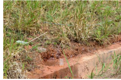
Điện cực đặt phía chân đập
