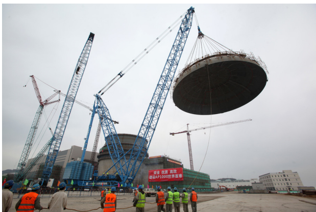
Công tác xây dựng đang được tiến hành tại nhà máy điện hạt nhân Sanmen của Trung Quốc, tháng 1 năm 2013
